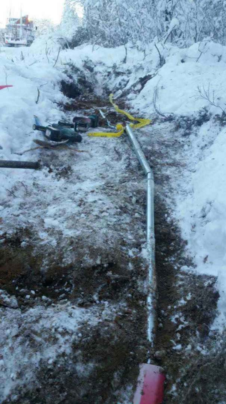
Kuva 5. Valmis kaapelin suojakouru (kuva Arto Malinen. mms_20171128_094703)
